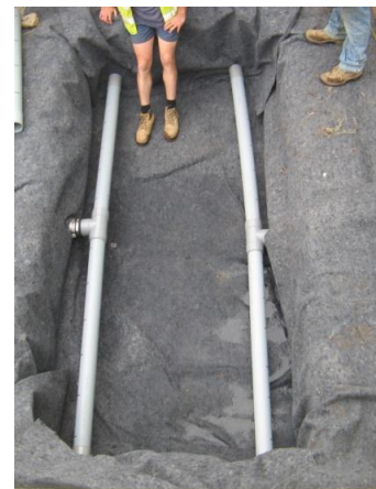
Vue des drains d'alimentation (gauche) et d'évacuation (droite)
