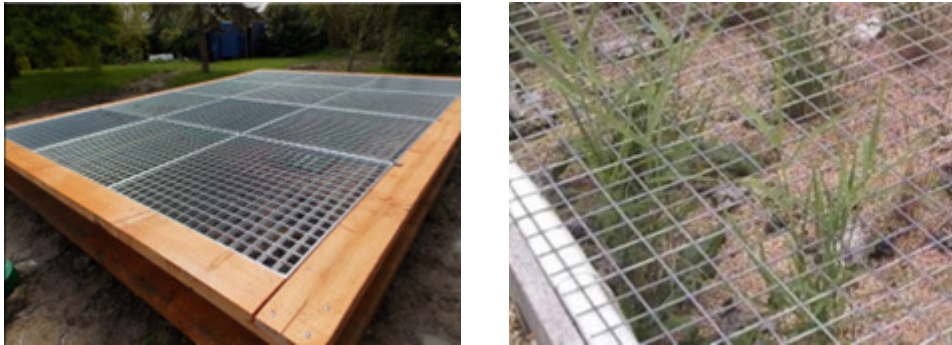
Exemple de grilles de protection sanitaire (avant pousse des roseaux)
