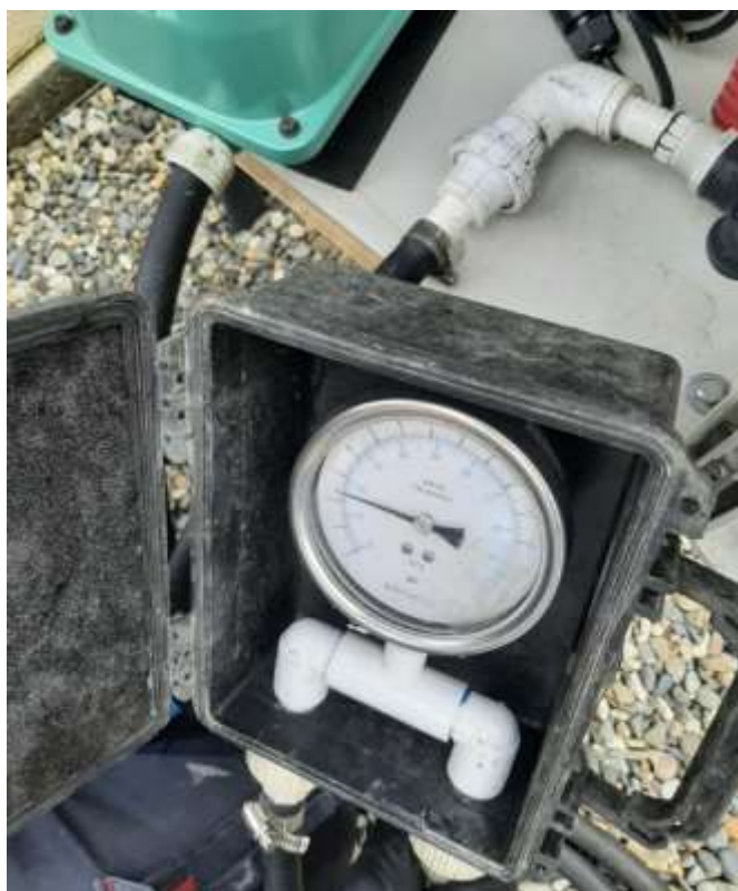
Figure 10: Mesure de la pression de service au manomètre
